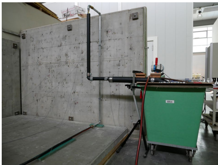
Abbildung 34: An einer Empfangsplatte montierte Trinkwasserleitung
